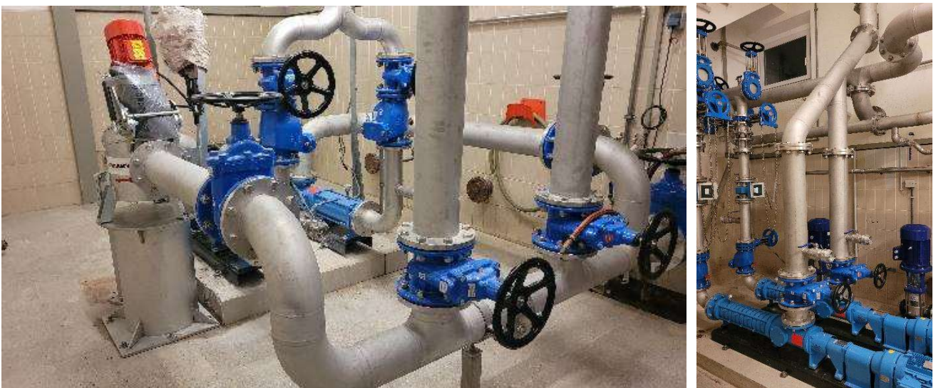
Abbildung 14: Neue Rohrleitungen und Pumpen des Schlammumpwerks
